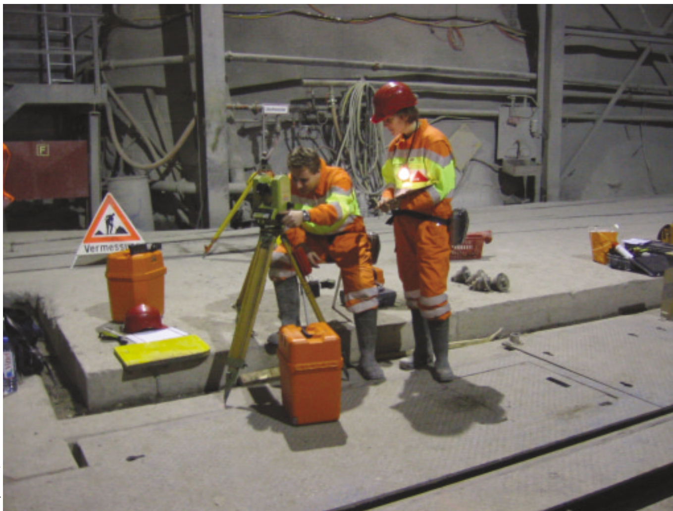
Figure 7. Mesures d'autocollimation au fonds du puits
